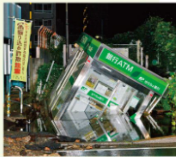
⑤ 水道管が破損して倒れた ATM (2014年 横浜市)
